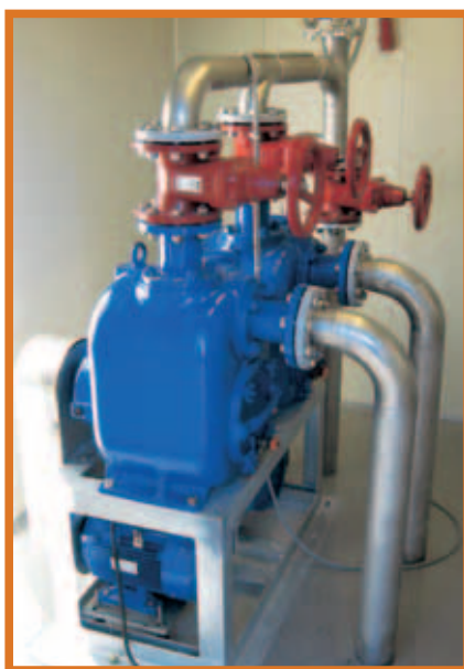
Stazione sollevamento fognatura Sewage lift station
